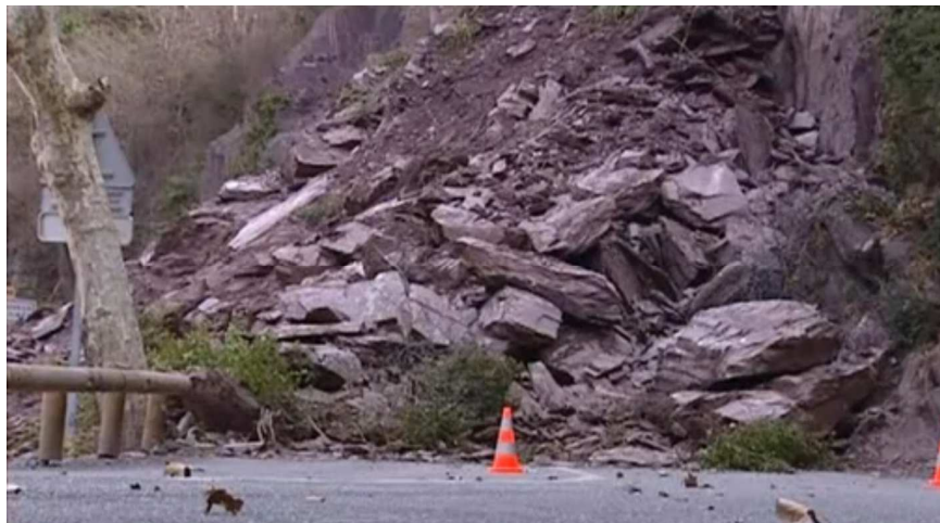
Figure 1 – L'éboulement rocheux du 25 février 2006 sur la RD 2205 à hauteur du village de Saint-Etienne-sur-Tinée (Capture du Journal télévisé de France 2 du 26 février 2006).
